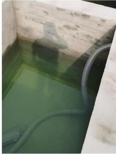
冲洗废水收集处理及回用池
